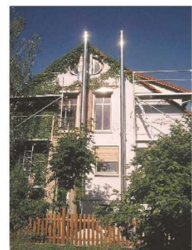
Außenwandkamine aus Edelstahl
